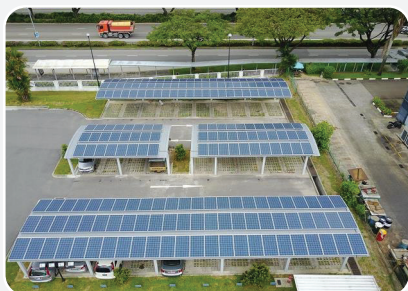
Bãi xe - Hóc Môn Parking lot - Hoc Mon Công suất/Capacity: 200kWp
