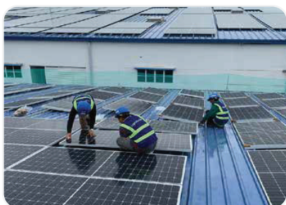
Nhà máy 1 viên nén Bình Định Pellet Factory 1 - Binh Dinh Công suất/Capacity: 1.5MWp
