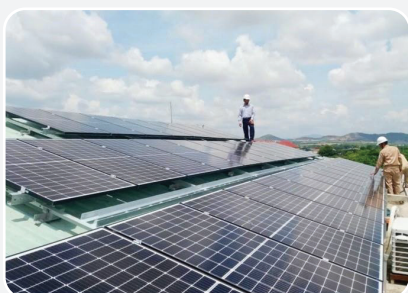
NM Sợi - Vũng Tàu Yarn Factory - Vung Tau Công suất/Capacity: 2.4MWp
