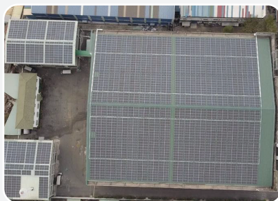
NM Meraki - Bình Dương Meraki Factory - Binh Duong Công suất/Capacity: 2MWp
