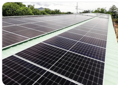
NM Hoàng Giang - Bình Định Hoang Giang Factory - Binh Dinh Công suất/Capacity: 1MWp
