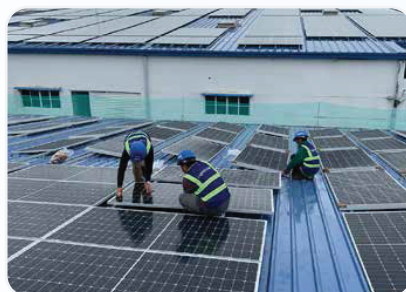
Cao su Kiên Kiệt TP. HCM Kien Kiet Rubber Ho Chi Minh City Công suất/Capacity: 300Kw
