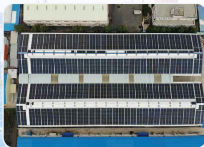
Nhà máy may Củ Chi Garment Factory - Cu Chi Công suất/Capacity: 500Kw
