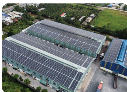
Nhà máy KV mực in Long An KV Ink Factory - Long An Công suất/Capacity: 560kw
